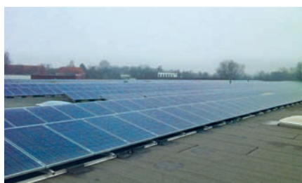
Industriehalle Fa. Ahlmann in Büdelsdorf, 626 kWp
