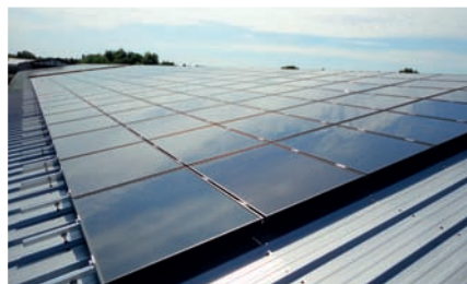
Dachflächenanlage in Glückstadt, 160 kWp
